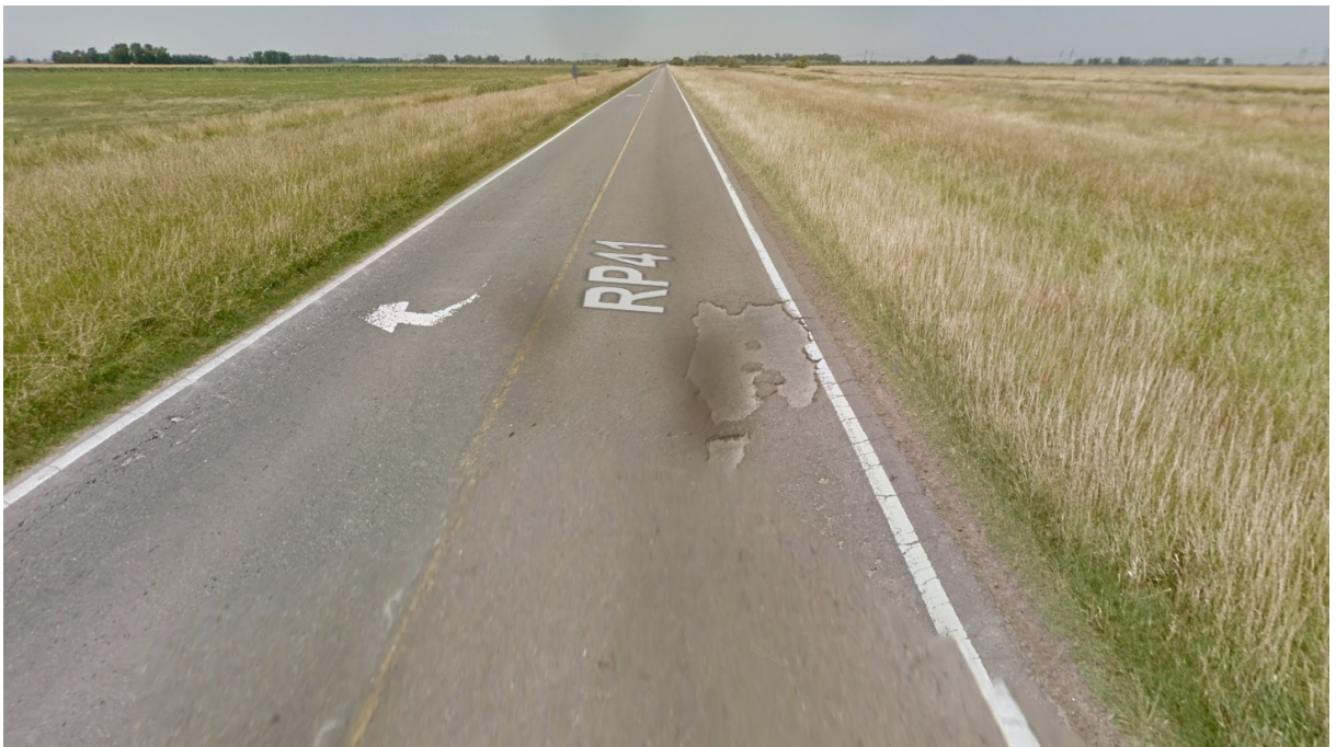
Imagen 4. Deterioro en la R.P. N°41. Partido de Navarro
