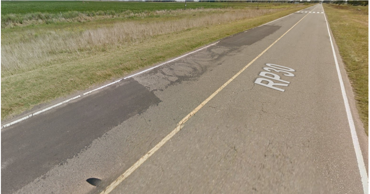
Imagen 3. Deterioro en la R.P. N°30. Partido de Las Flores.
