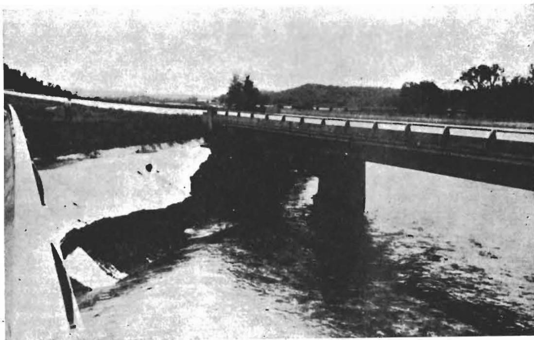
Figura 3.— Un aspecto de los daños causados por una riada en el muro de protección de un puente sobre el East Bureau Creek en Illinois.
