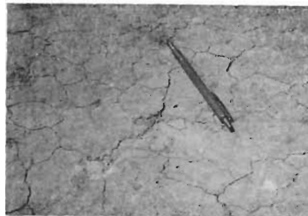
Fotografía 10 — Fisuras superficiales de contracción en capa de suelo-cal (subrasante).
