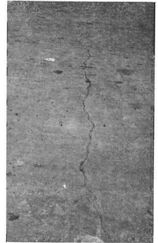
Fotografía 12. - Fisura superficial (tramo C, progresiva 279,35 m).
