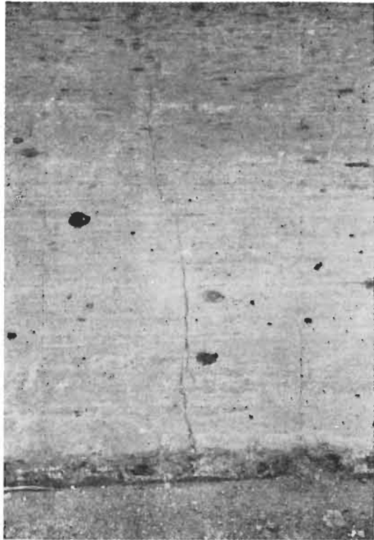
Fotografía 9. — Fisura superficial (tramo B).
