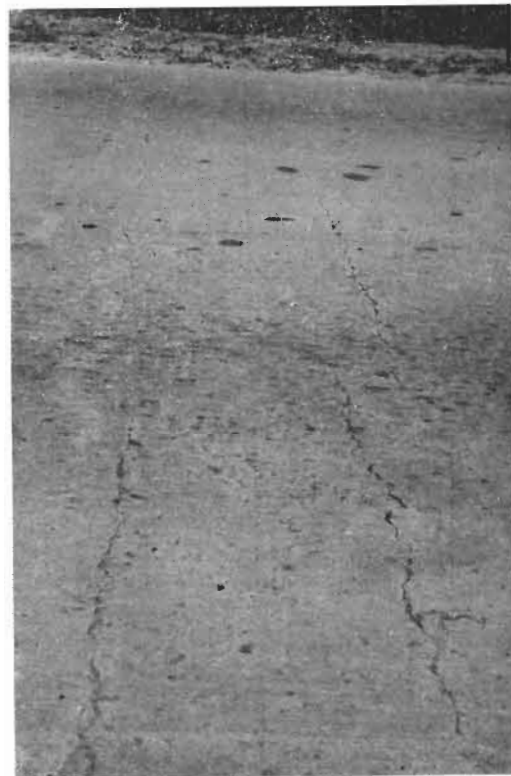
Fotografía 11. - Fisura superficial (tramo C, progresiva 325,15 m).
